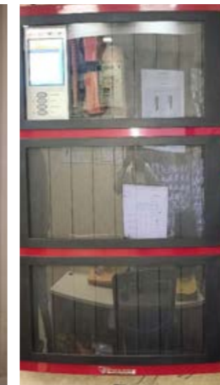
New System - EST 4
