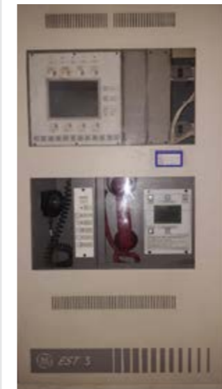
Old System - EST 3
